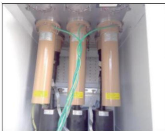
电缆室 Cable Room
